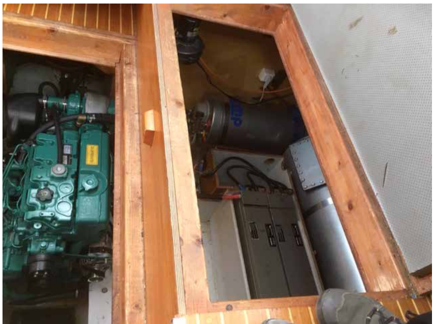
På babordssidan i maskinrum: dieseltank, förbrukarbatterier och varmvattenberedare
